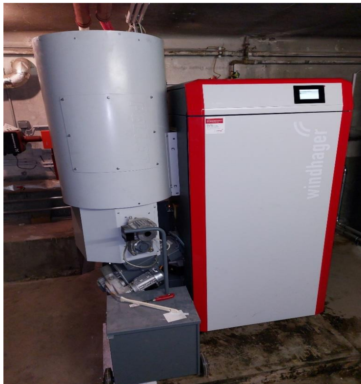
Abbildung 5.1: Pelletskessel in der Bestattung Mödling
