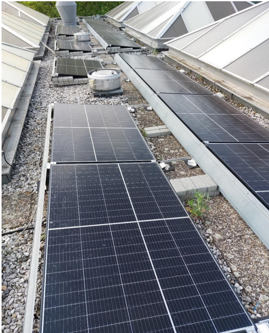
Abbildung 4.2: 13 - PV-Anlage Wasserwerk Moosbrunn
