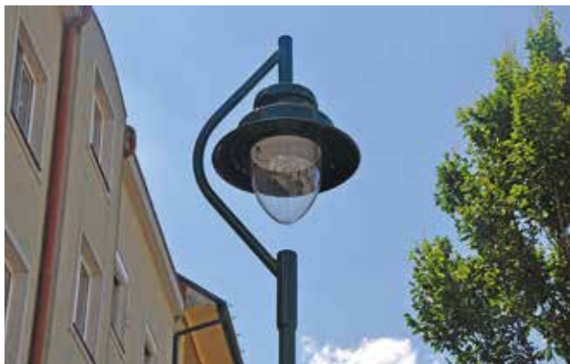
Formschön und effizient präsentieren sich die Leuchten, die im Zuge der Umstellung auf LED-Technik zum Einsatz kommen.
