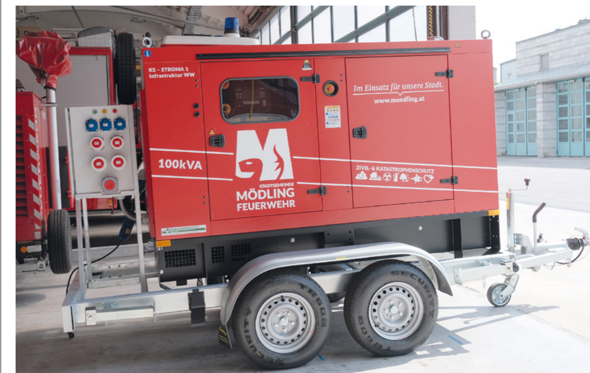
Mödling verfügt über mobile Notstromaggregate, die im Notfall flexibel eingesetzt werden können.
