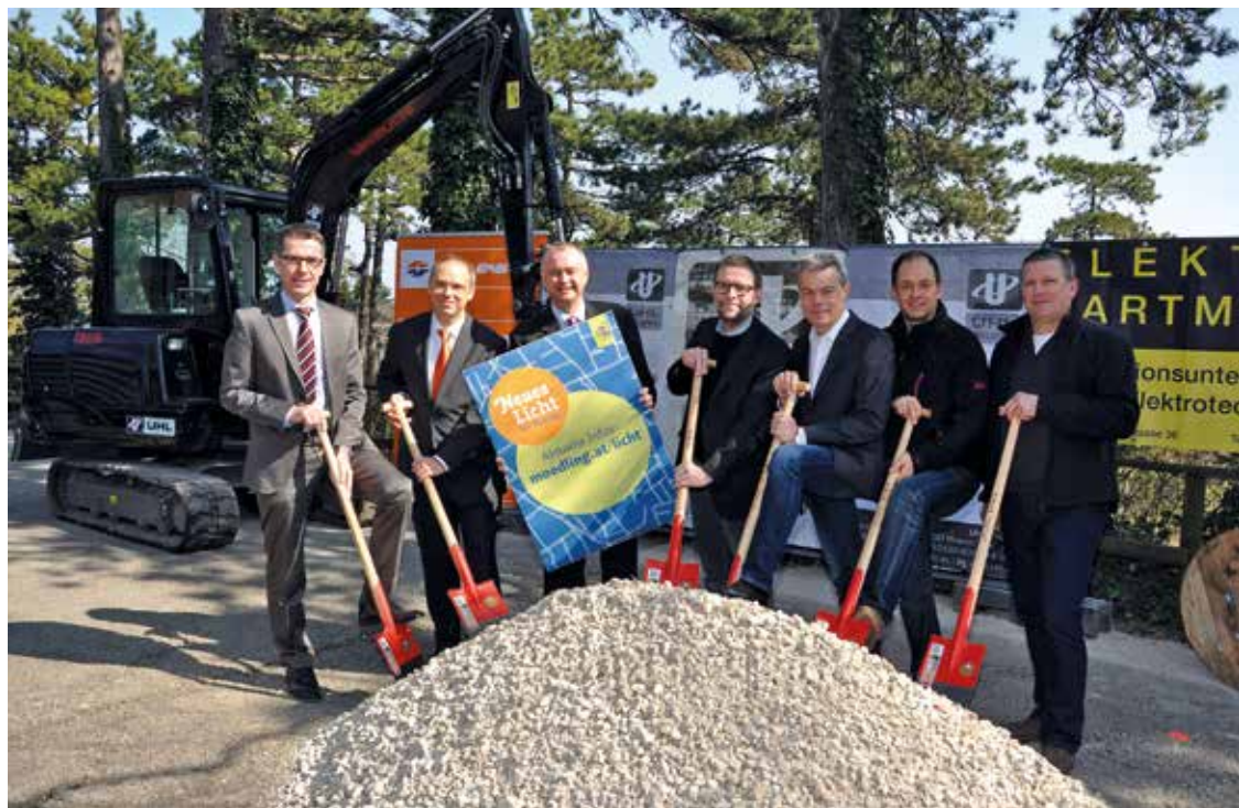
Spatenstich und Projektstart für „Neues Licht für Mödling“: Leopold Wanzenböck von Naturkraft, Mag. Thomas Pucharski von Wien Energie, Bürgermeister LAbg. Hans Stefan Hintner, Vizebürgermeister Mag. Gerhard Wannemacher, Gemeinderat Klaus Percig, Abteilungsleiter Ing. Alexander Steppan und Ing. Werner Gruber von der Firma Uhl.
