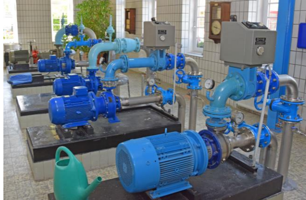
Pumpenhalle in der Quellenstraße
