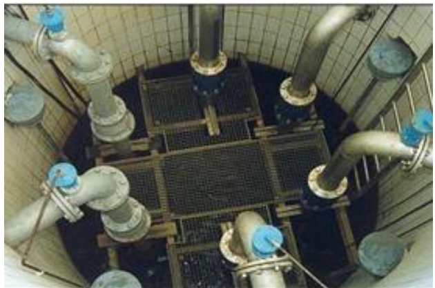
Horizontalfilterbrunnen in Moosbrunn
