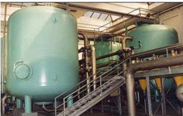
Aktivkohlefilteranlage in Moosbrunn
